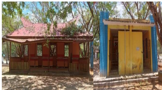
Gambar: 4: prasarana yang tidak terpakai lagi dibiarkan tidak terawat sehingga merusak pemandangan. Tampak WC dan lapak tampak kumuh karena tidak terurus.
